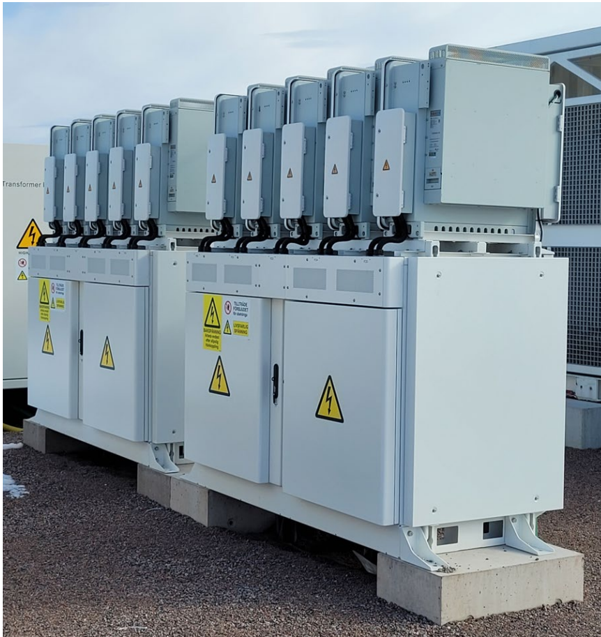
Figur 8. Exempel på stativ med växelriktare. Bildkälla: Vinnergi AB.
