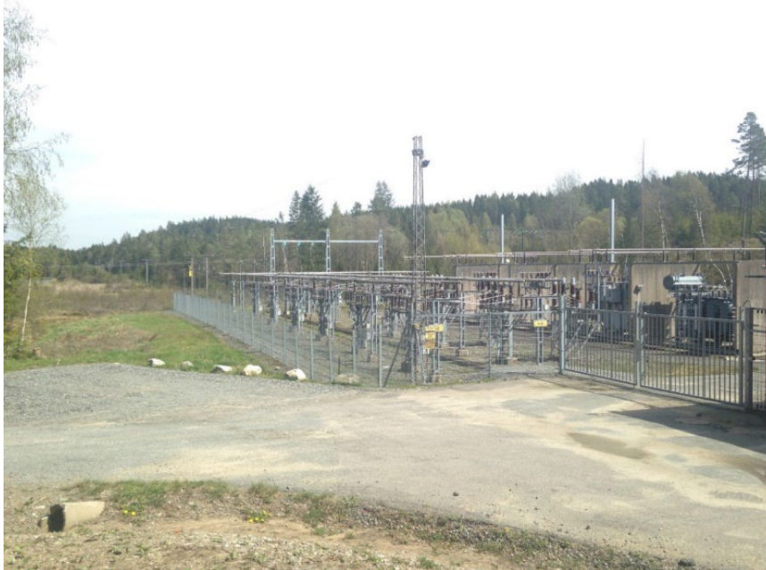
Figur 4. Illustration av en inhägnad transformatorstation. Bildkälla: Vinnergi AB.
