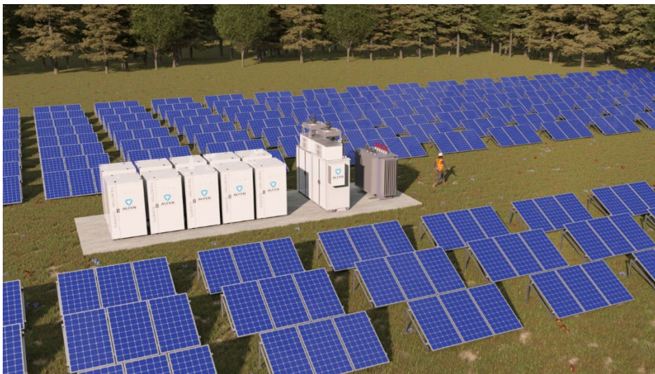
Figur 6. Exempel på öppen lösning. Anläggningen på bilden består av 8 energilagringseenheter/batterier placerade intill växelriktare och transformator placerat på en betongplatta. Bildkälla: Alfen.
