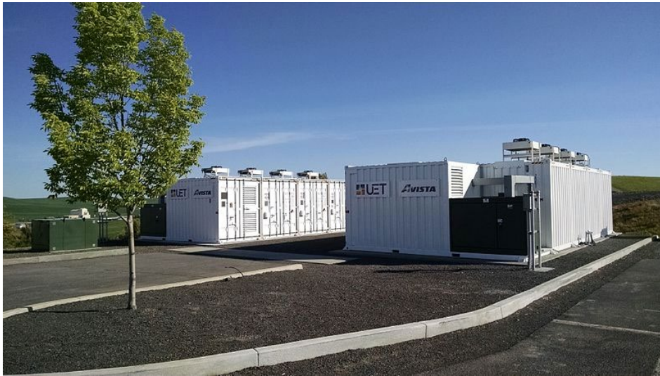
Figur 5. Exempel containerbatteri. Bildkälla: Wikimedia Commons
